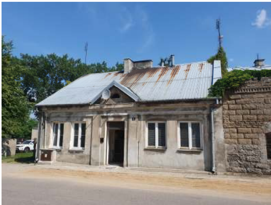
Zdjęcie 1 – Obecny wygląd budynku, widok od ulicy, widoczne plamy rdzy na dachu i uszkodzenia powierzchni tynku zwłaszcza w strefie gzymsu.
