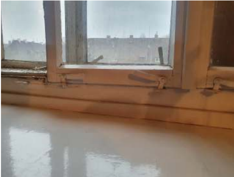
Zdjęcie 7 – widoczna korozja biologiczna ościeżnicy i brak szyb
