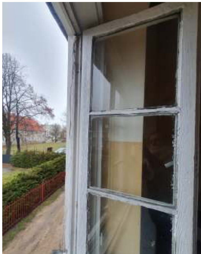
Zdjęcie 4 – skrzydło zewnętrzne – brak skrzydeł wewnętrznych
