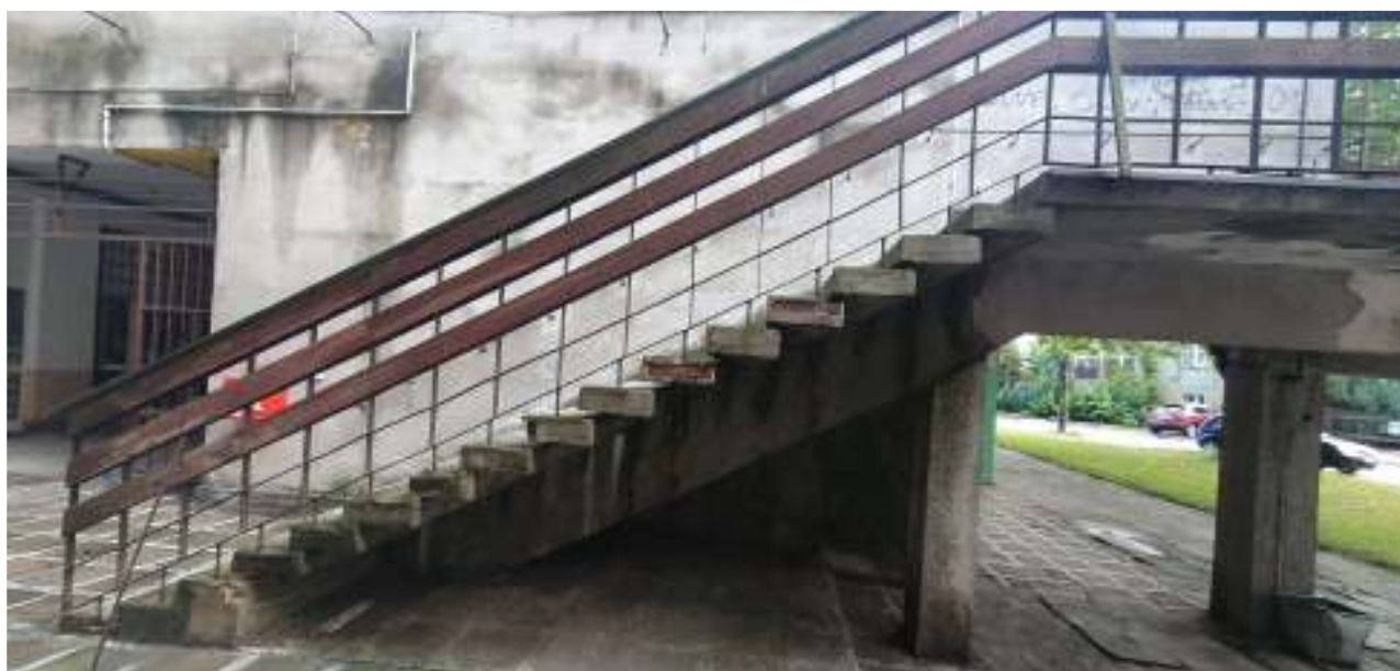
Dolny bieg schodów - widoczna korozja betonu
