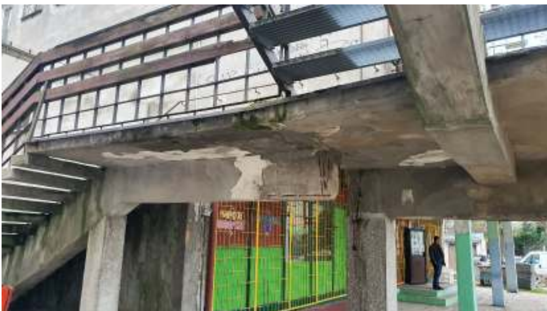
Widoczne odkryte zbrojenie belki
