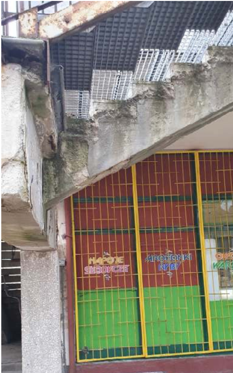
Belka policzkowa górnego biegu - widoczna korozja biologiczna betonu
